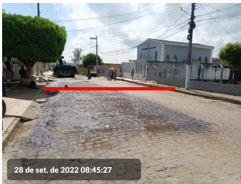
Imagem 01 – Avenida Machado, em frente à casa nº 249.
